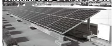
▲屋根に設置されているパネル
