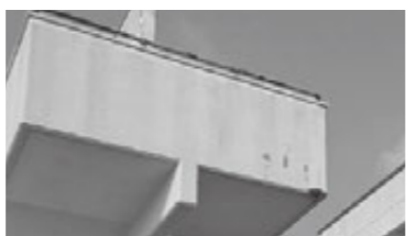
老朽化が進む西原東小学校(外装の剥離)
